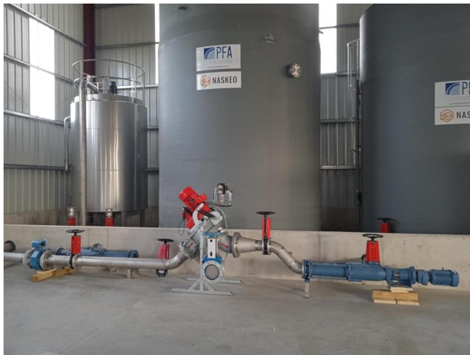
Hygiéniseur et cuve calorifugée hygiénisée
