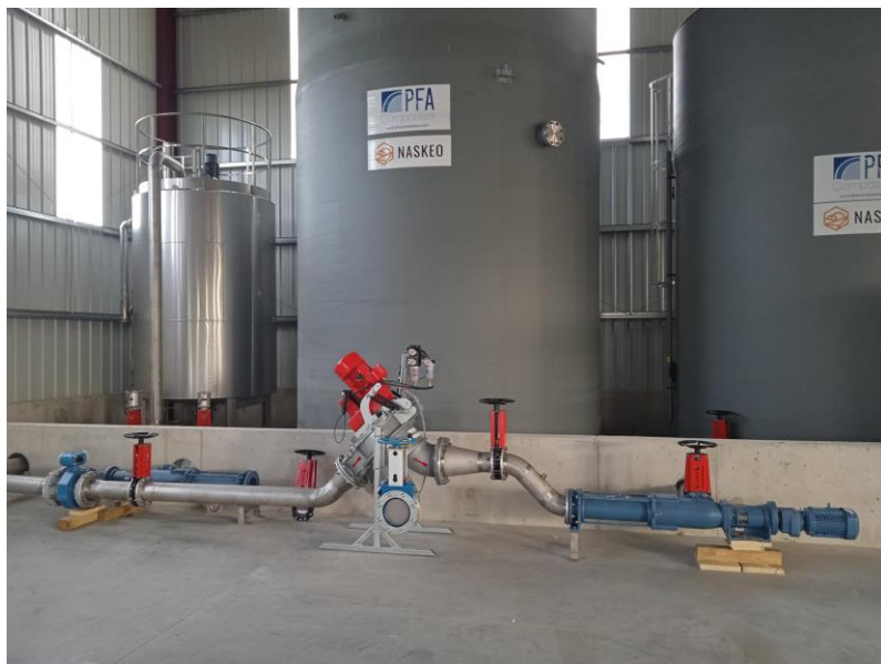
Hygiéniseur et cuve calorifugée
